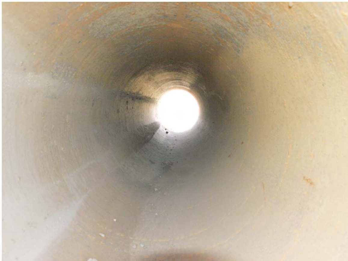
تصویر ۲-نمای داخل لوله چدنی نشکن سایز ۵۰۰ میلی متر پس از ۳۵ سال سرویس دهی
